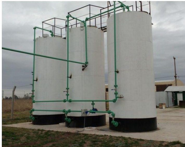
Imagen N°6: Planta de tratamiento físico-químico
